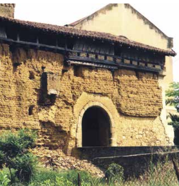
Façade ouest du rempart en terre crue, avant sa restauration : une succession de couches de terre crue filantes.
