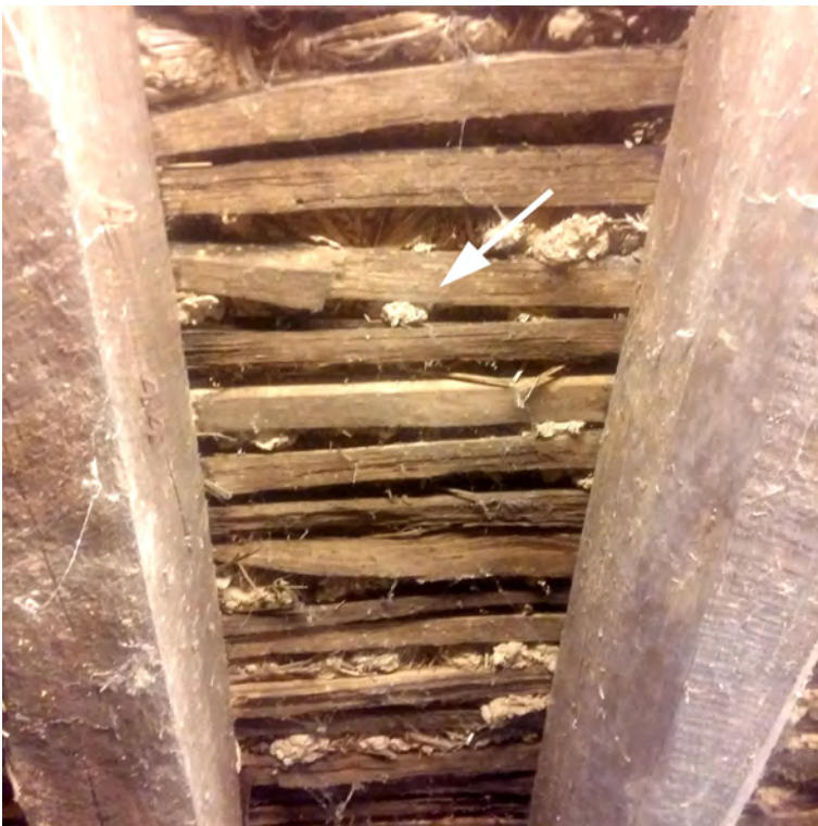
Illustration 18: un lattis au sol formant plancher non jointif et support de chape, vu par dessous (Mylène Gajic)
