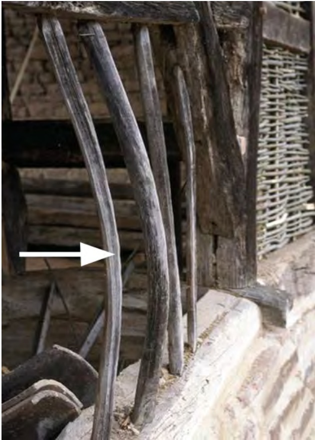
Illustration 8: un palançon, support de clayonnage ou première trame. (© Médiathèque de l'architecture et du patrimoine (Centre de recherche des monuments historiques - CRMH) diffusion RMN, Charles Hurault)
