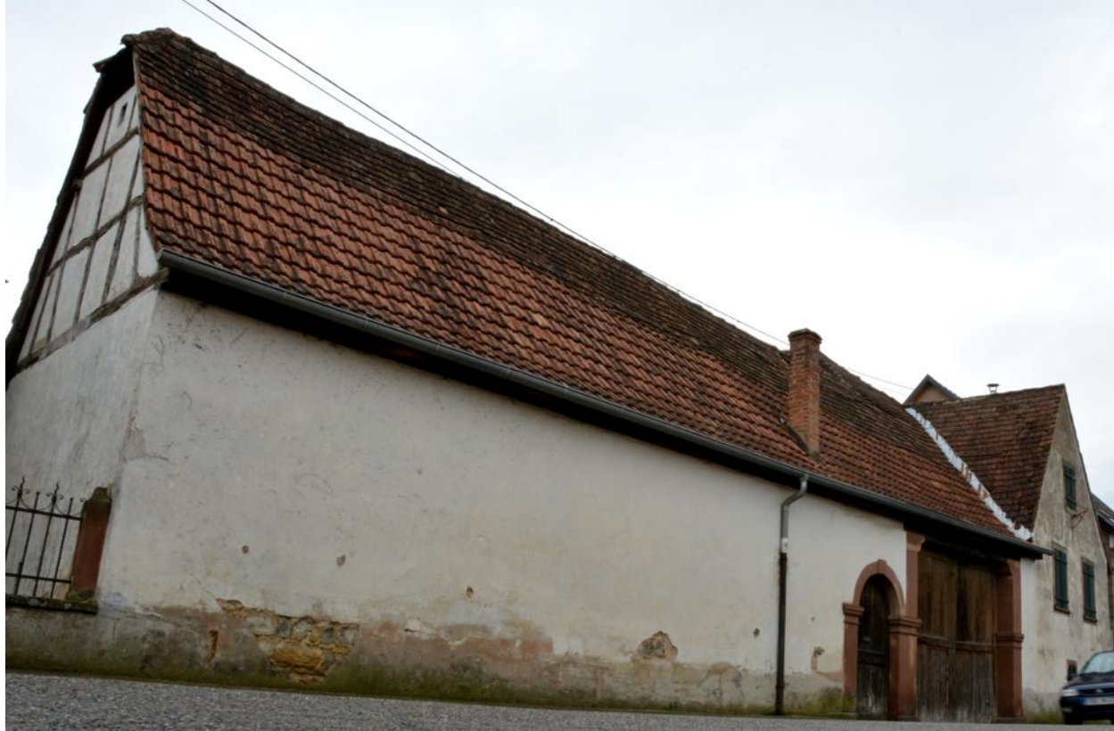
À Hochfelden, comme dans d'autres villages alsaciens, l'Asma veut sauver le patrimoine rural de la démolition.
